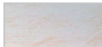
Isolierwirkung auf Holz: Wasserlösliche Holzinhaltstoffe bluten durch
